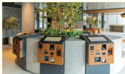
フロントロビー (自動チェックイン機) Front Lobby (Self check-in machine)
