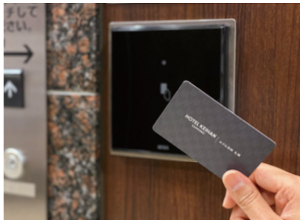
エレベーターセキュリティ Elevator security
